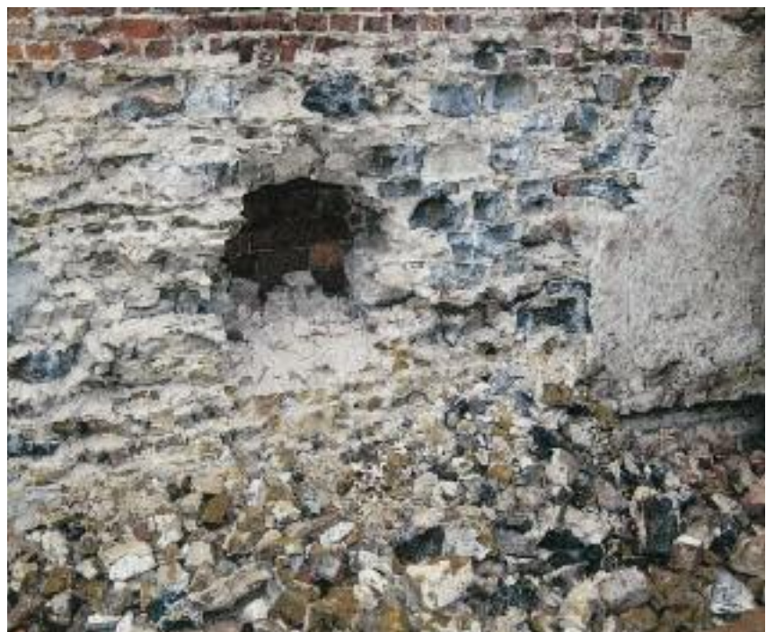
Das Loch in der Grenzmauer zum Nachbargrundstück Mülheimer Straße 2 - 4
