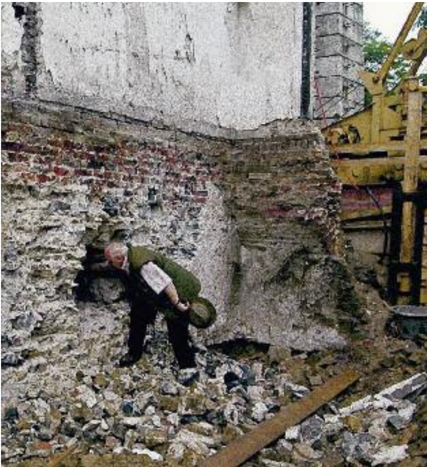
Blick aus der Baugrube zur Mülheimer Straße hin. Die Grenzmauer zum Nachbargrundstück Mülheimer Straße 2 - 4 scheint eine Fundamentmauer von beträchtlicher Stärke zu sein
